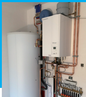
Warmtepomp met buffervat
